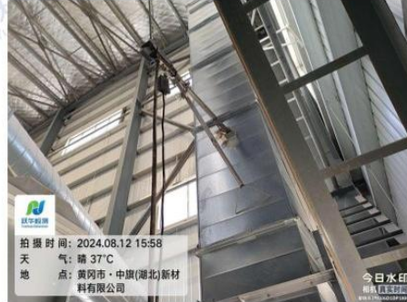
DA002 混料废气排气筒 1①YQ2
